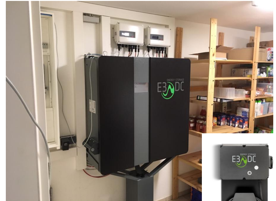
Innovatives E3DC Hauskraftwerk (inkl. Wechselrichter + Batterie+Leistungselektronik.)
