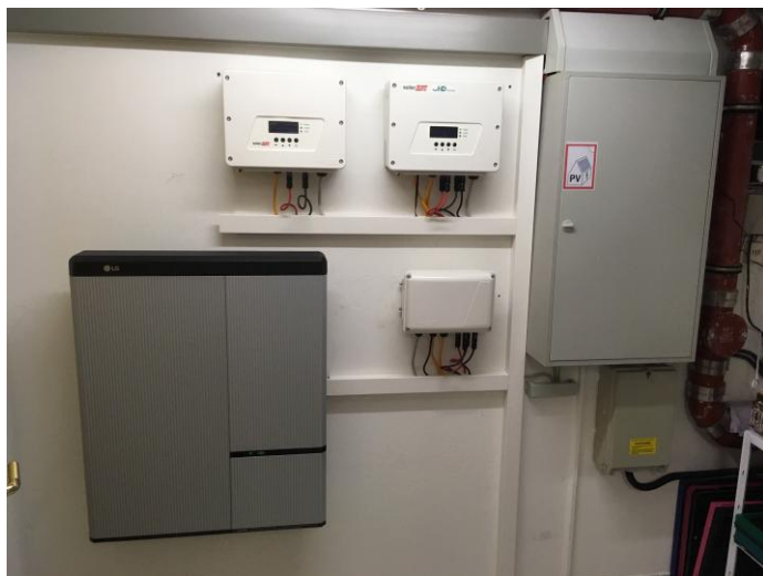
SolarEdge Optimierer+Hybrid-Wechselrichter plus LG-Batterie
